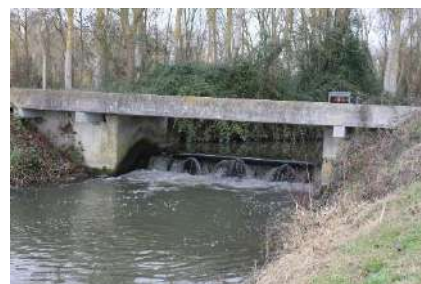
Clapet sur le Couasnon situé en amont de l'A 85, faisant obstacle à la continuité aquatique (n°2)
